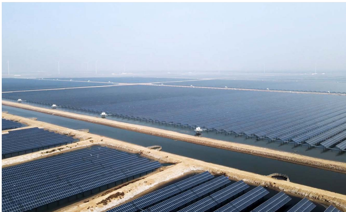
中国山东滨州沾化“渔光一体”项目
